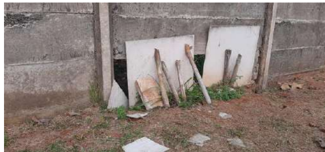
Gambar 2. Pagar panel beton sebagai pembatas lingkungan RW 07 dengan warga yang mengalami kerusakan ditutup seadanya.
