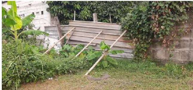
Gambar 1. Pagar panel beton sebagai pembatas lingkungan RW 07 dengan warga yang mengalami kerusakan dibatasi dengan seng gelombang.
