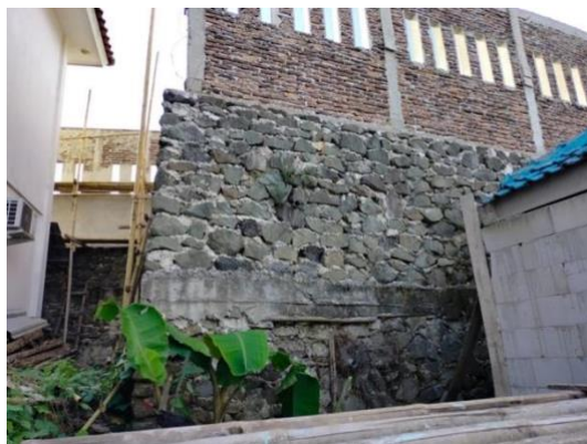
Gambar 4. Dinding penahan tanah yang sudah dibangun di sisi kanan lahan dilihat dari sisi luar
