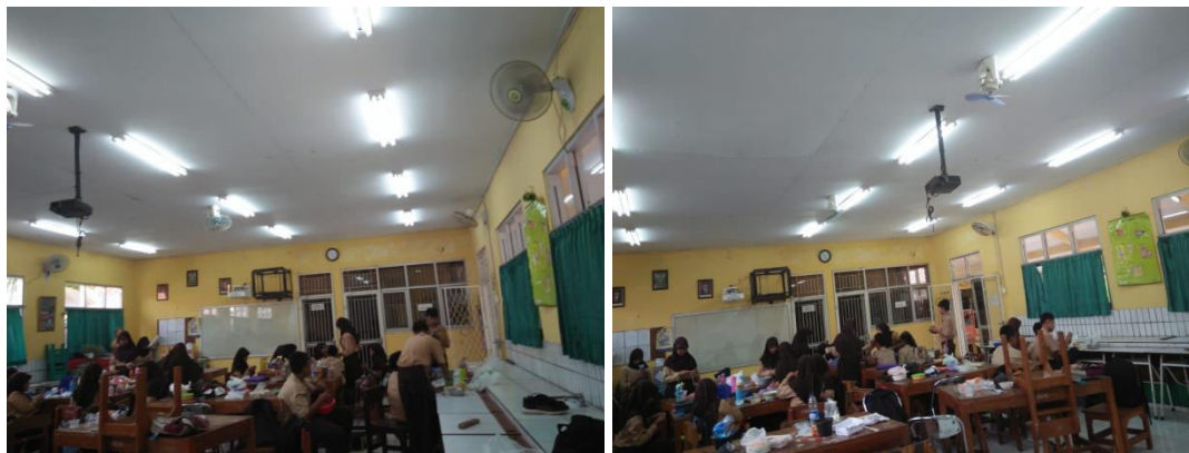
Gambar 5.11 Kondisi ruang laboratorium IPA setelah retrofit lampu
