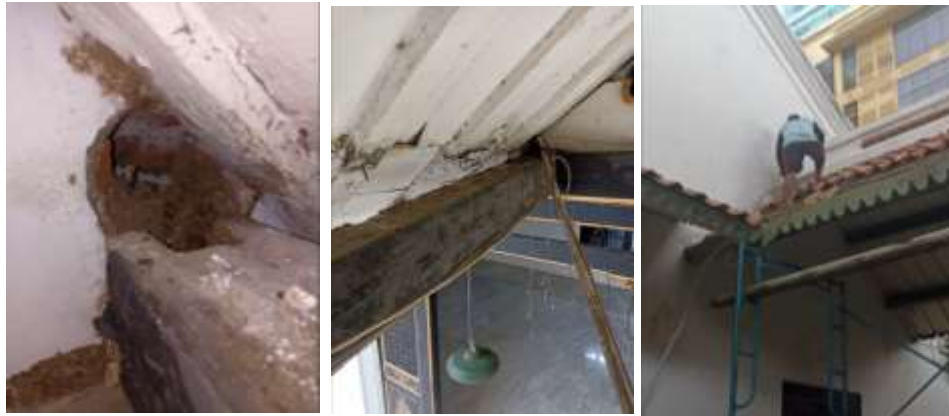
Gambar 5. Gambar Kerusakan kayu dan genteng pada Bangunan Penghubung 1 Sumber: Dokumentasi pribadi 2023
