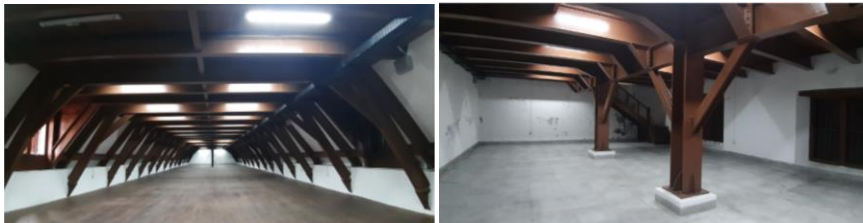
Gambar 4. Dinding Lantai 2 dan 3 Yang selalu Mengelupas Setelah Diadakan Pengecatan (Sumber: Foto Pribadi, 2021)
