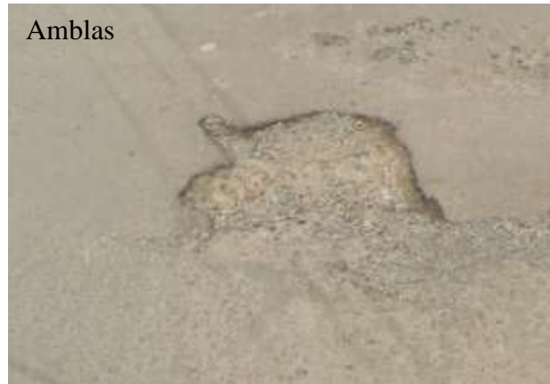
Gambar 4.7 Gambar Kerusakan Perkerasan Jalan Seksi 3
