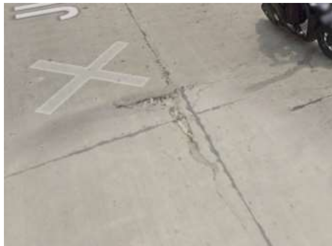
Gambar 1.6 Kerusakan Perkerasan Kaku di Jalan Pondok Cibubur
