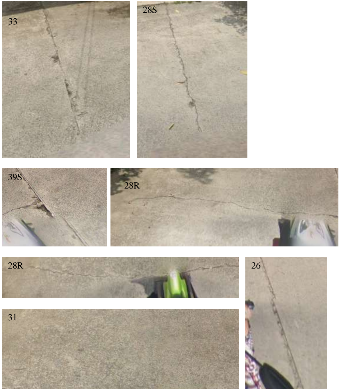
Gambar 4.13 Gambar Kerusakan Perkerasan Jalan Seksi 6
