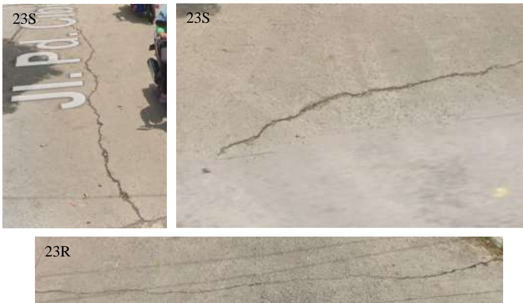
Gambar 4.8 Plot Kerusakan Perkerasan Jalan Seksi 4
