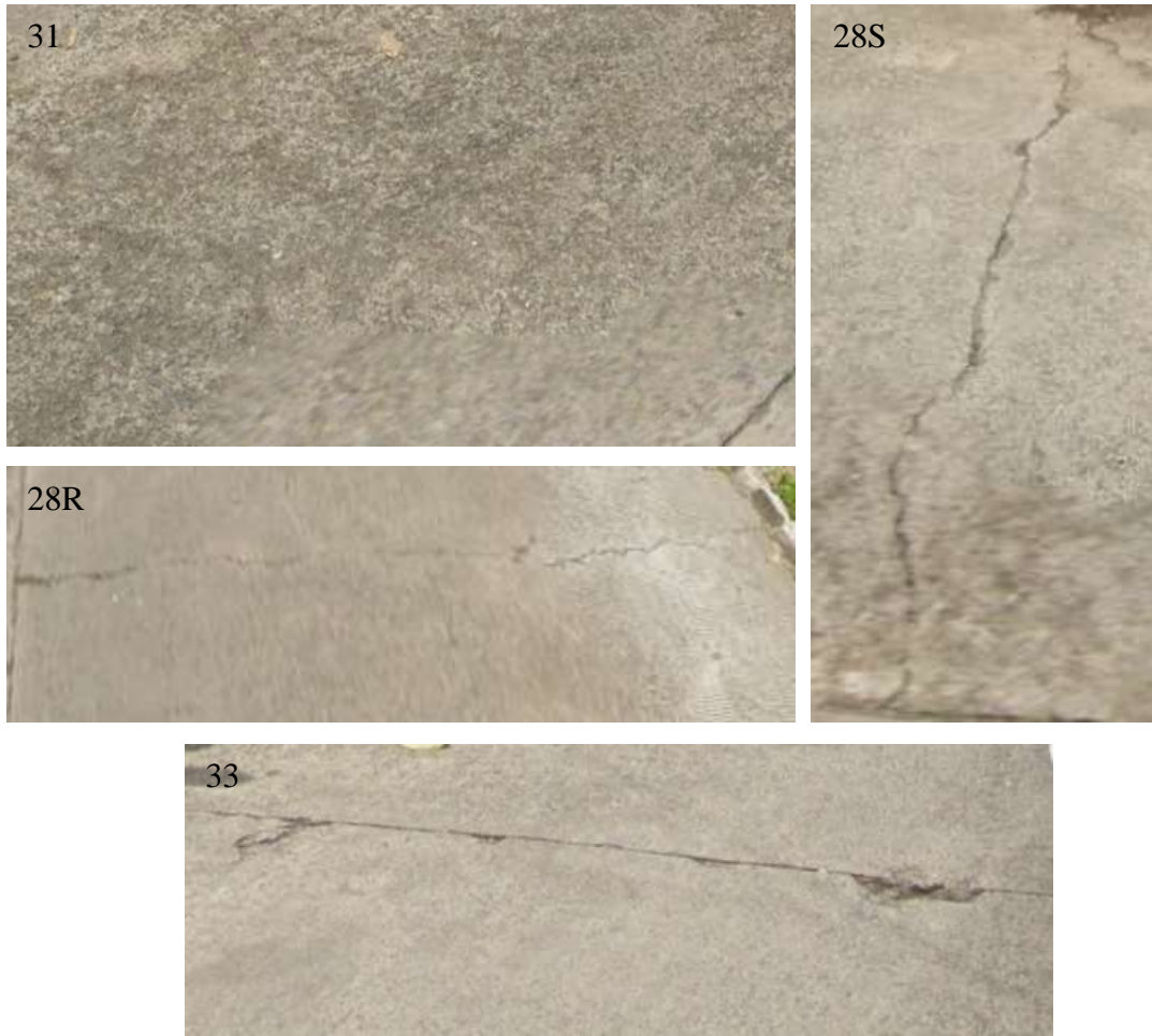
Gambar 4.11 Gambar Kerusakan Perkerasan Jalan Seksi 5
