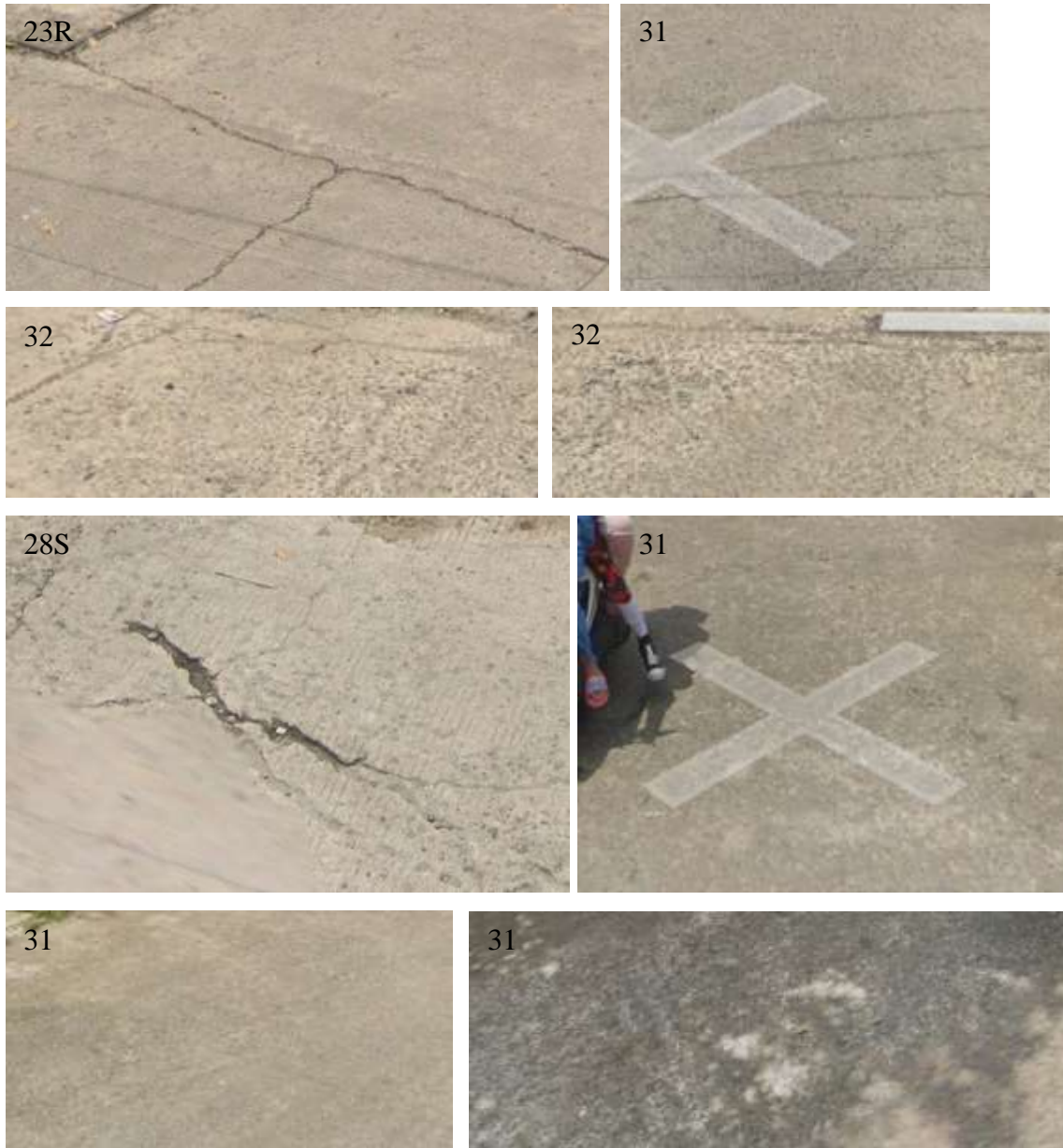
Gambar 4.9 Gambar Kerusakan Perkerasan Jalan Seksi 4
