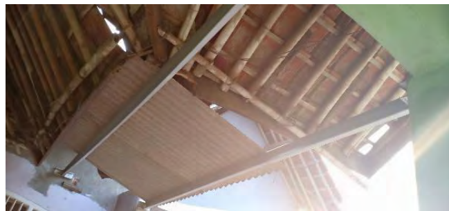
Gambar 9. Kerusakan Rangka Atap pada Sisi Kanan Majelis Taklim Al Musa'adah (Sumber: Dokumentasi, Juli 2019)
