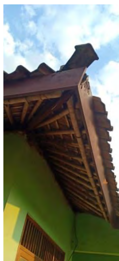
Gambar 7. Papan Lisplang dan Genteng yang Rusak pada Sisi Jurai Atap (Sumber: Dokumentasi, Juli 2019)
