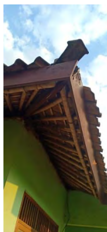
Gambar 1.14 Papan Lisplang dan Genteng yang Rusak pada Sisi Jurai Atap (Sumber: Dokumentasi, Juli 2019)
