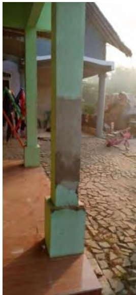
Gambar 4. Kolom dengan Tambalan Plesteran tanpa Finishing Cat (Sumber: Dokumentasi, Juli 2019)
