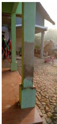
Gambar 1.11 Kolom dengan Tambalan Plesteran tanpa Finishing Cat (Sumber: Dokumentasi, Juli 2019)
