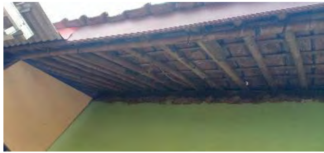
Gambar 8. Rangka Atap Terekspos karena Tanpa Penutup Plafon (Sumber: Dokumentasi, Juli 2019)
