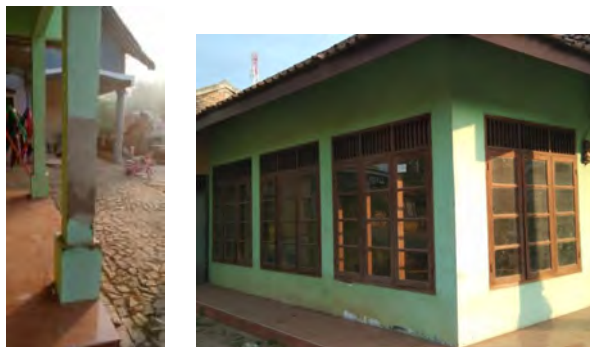
Gambar 2.2 Kondisi Dinding dan Kolom di Lapangan (Sumber: Survei, Juli 2019)
