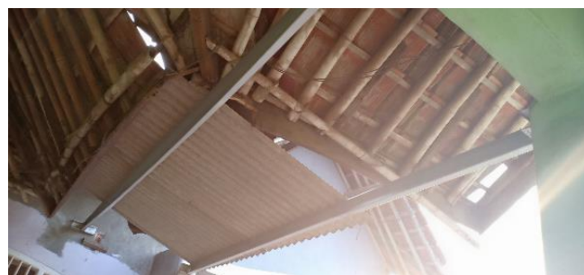
Gambar 7. Kerusakan Rangka Atap pada Sisi Kanan Majelis Taklim Al Musa'adah (Sumber: Dokumentasi, Juli 2019)
