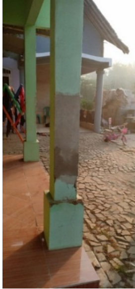
Gambar 2. Kolom dengan Tambalan Plesteran tanpa Finishing Cat (Sumber: Dokumentasi, Juli 2019)
