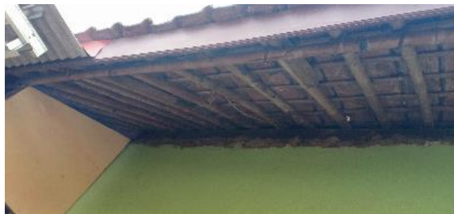
Gambar 6. Rangka Atap Terekspos karena Tanpa Penutup Plafon (Sumber: Dokumentasi, Juli 2019)
