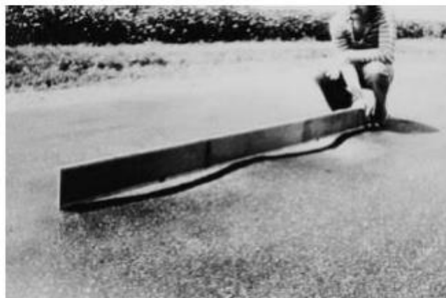
Gambar 7. Kerusakan Aspal Keriting (Hardiyatmo, 2015)
