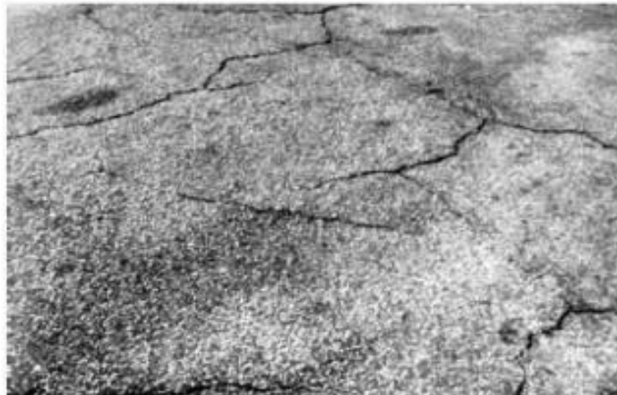
Gambar 1. Retak kotak-kotak / block cracking (Hardiyatmo, 2015)
