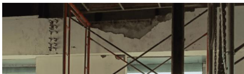
Gambar 13. Pengupasan selimut beton pada balok B_{ext}
