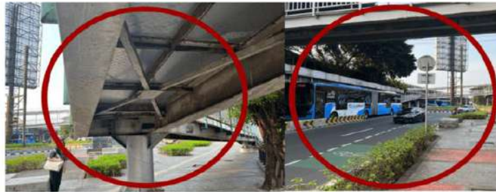
Gambar 14. Dokumentasi sistem struktur JPO eksisting dan jarak bersih dari muka jalanan pada kunjungan tapak. Sumber: Olahan Penulis, 2023
