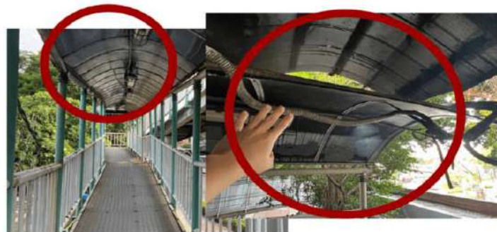
Gambar 11. Dokumentasi kondisi rusak dan usang atap polikarbonat. Sumber: Olahan Penulis, 2023
