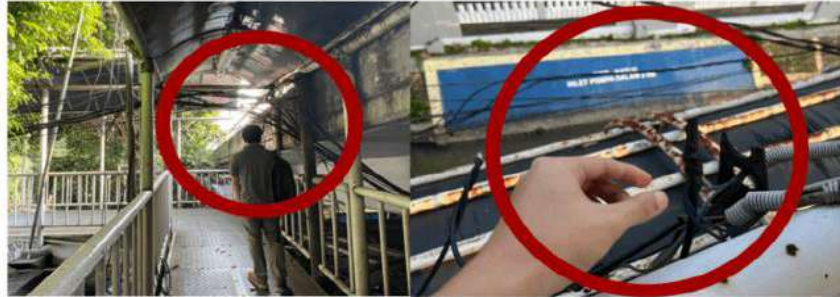
Gambar 13. Dokumentasi kegagalan fungsi railing Sumber: Kodoatie, 2005
